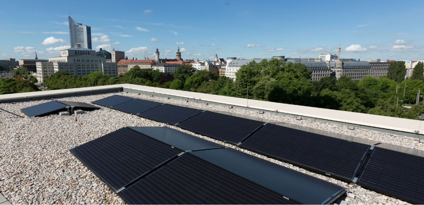
Die LWB hat auch auf ihrer Zentrale eine Photovoltaik-Anlage installiert.
